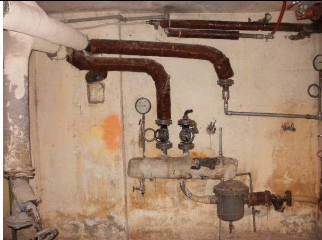
Fot .20 Komin z przewodem wentylacyjnym i rozdzielacz c.o
