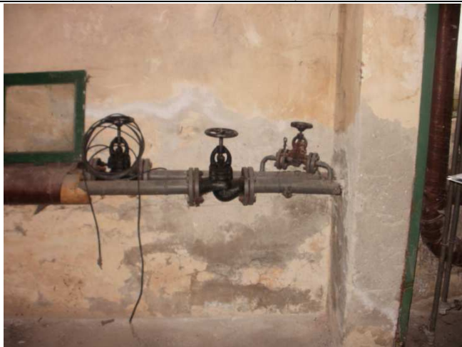
Fot .19 Pomieszczenie węzła c.o
