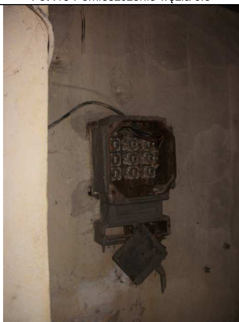
Fot .21 Stara tablica elektryczna z bezpiecznikami (Rys.IA-3 pom.tech.011)
