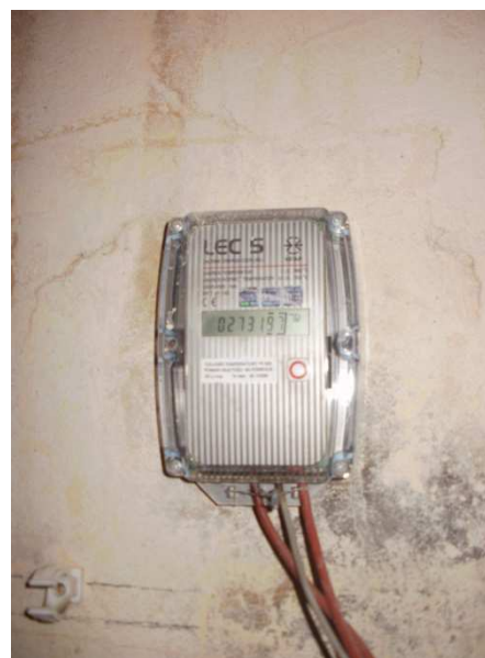
Fot .22 Element licznika ciepła
