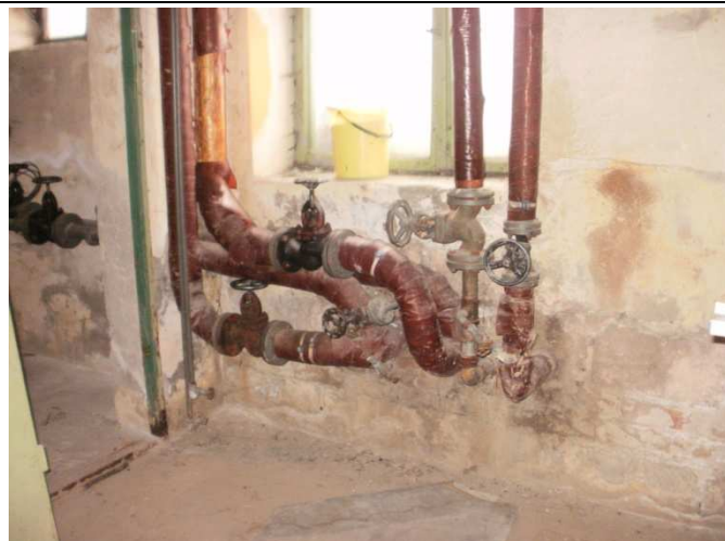
Fot .18 Pomieszczenie węzła c.o
