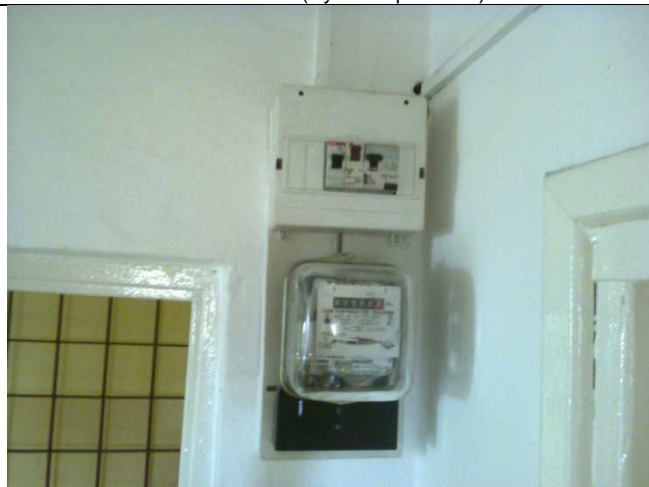
Fot .48 Tablica bezpiecznikowa z licznikiem pomiaru zużycia energii (Rys.IA-5 korytarz 208)
