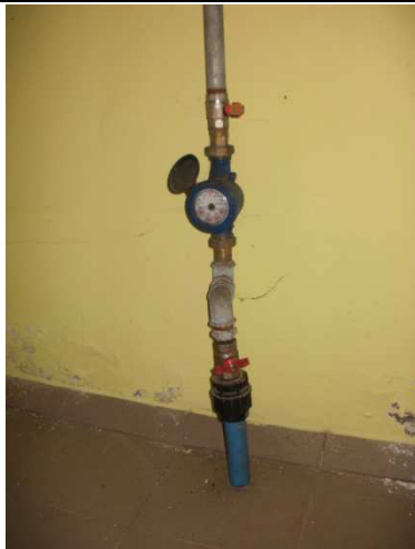
Fot .15 Wodomierz skrzydełkowy w magaz.odpadów med.(Rys.IA-3
