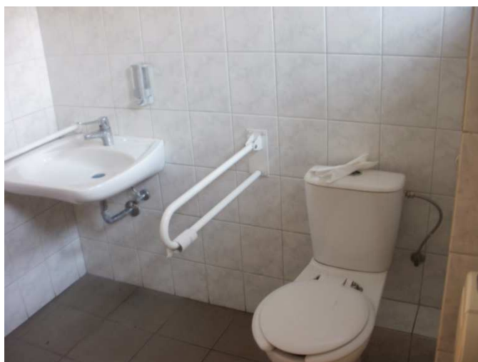
Fot .31 WC dla niepełnosprawnych (Rys.IA-4 pom.110)
