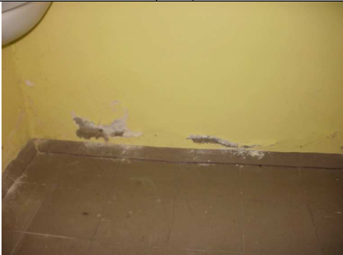
Fot .17 Wykwity solne na ścianie zewnętrznej (Rys.IA-3 pom.04)
